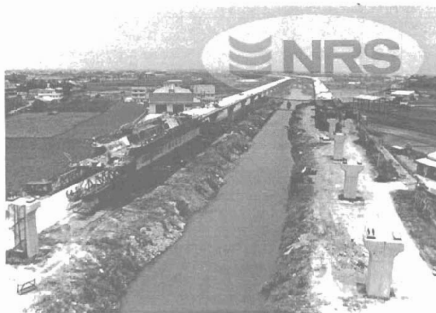
Hình 1.9: Cầu cạn được xây dựng bằng công nghệ ĐGDD chạy dọc suốt theo 2 phía bờ kênh
